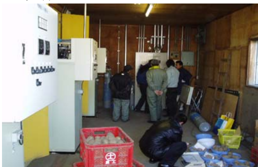
写真 1. 実験棟の内部、 左側に貯蔵庫 1、2、3 室 正面奥にコンロコントロール盤
